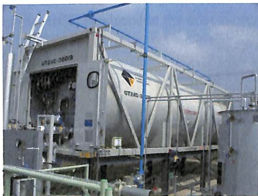
LNG Tank (horizontal)
