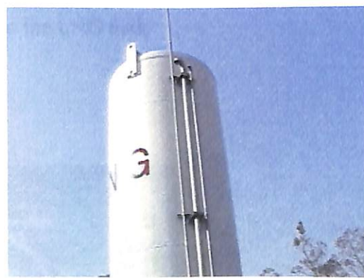
LNG Tank (vertical)
